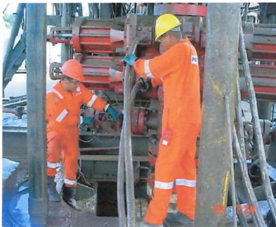
Figura 5 – Plataformista instalando Blow Out Prevent (BOP)
